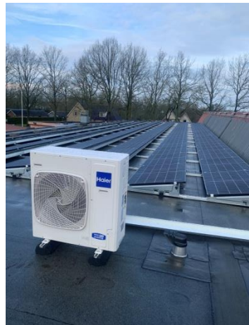
Buitenunit op het dak
