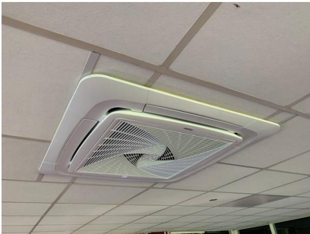
Airco in het plafond
