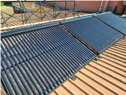
Haetpipes op het dak
