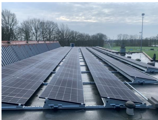
Zonnepanelen op het dak van de kantine
